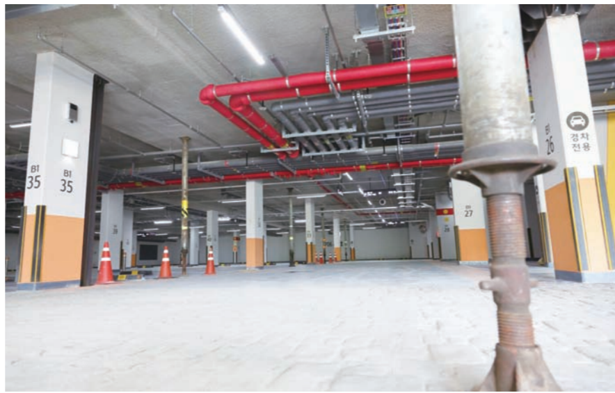
한국토지주택공사(LH) 발주 아파트 단지 중 철근 누락 등 문제가 발견된 20곳서 47건의 계약 해지 신청이 접수됐다. 경기도 오산시 세교2 A6블록 아파트 주차장 모습. 박미나 선임기자
